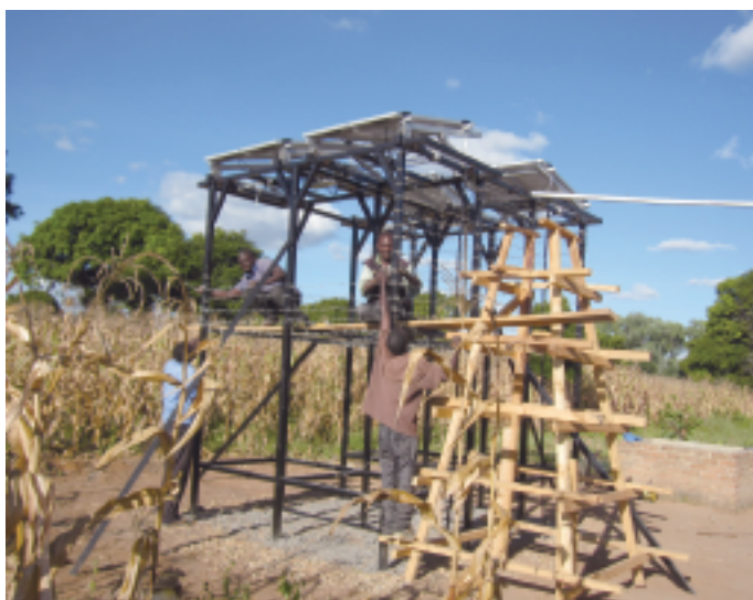
盗難防止のため、ソーラーパネルの設置台に有刺鉄線を巻いている
